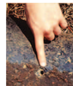
Typische Perforation einer unzureichend vor Streuströmen geschützten Kanalisation.
